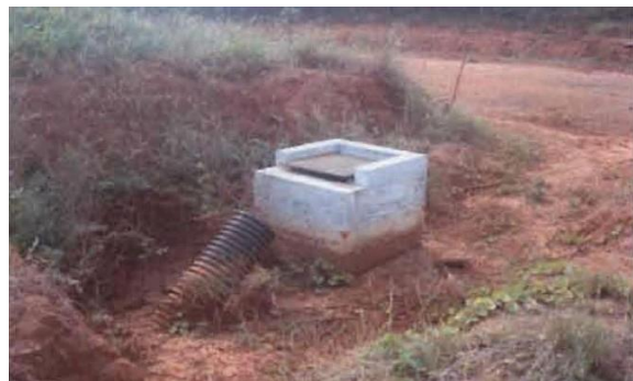
Figura 14 – Caixas de drenagem com tubo desconectado
