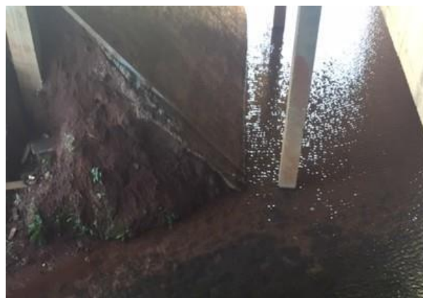
Figura 10 – Alagamento no subsolo do edifício central
