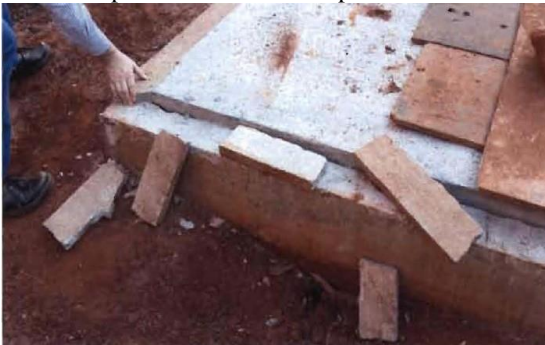
Figura 15 – Deslocamento da argamassa utilizada na caixa de drenagem
