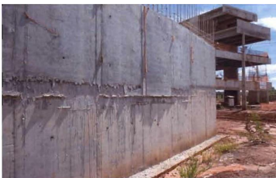
Figura 13 – Qualidade deficiente da superfície do concreto aparente da escada do prédio de aulas
