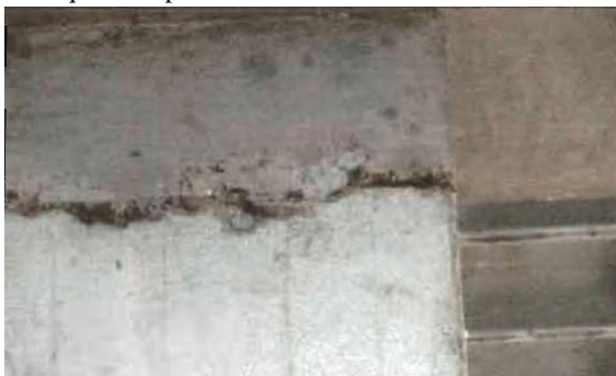
Figura 7 – Necessidade de reparos nas peças estruturais para evitar a corrosão do aço
