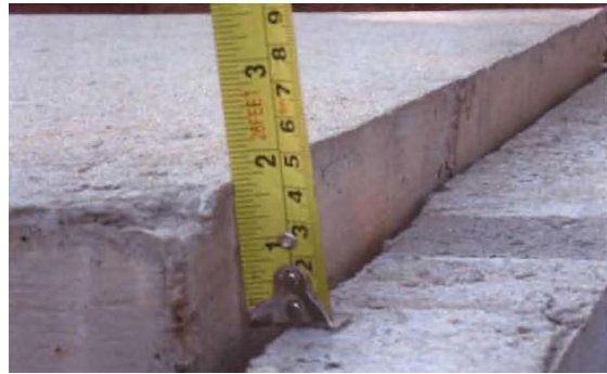
Figura 16 – Desnível verificado na tampa da caixa de drenagem
