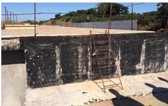
Figura 11 – Desplacimento da proteção mecânica da manta de impermeabilização
