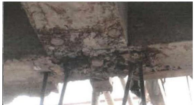
Figura 6 – Necessidade de reparos nas peças estruturais para evitar a corrosão do aço
