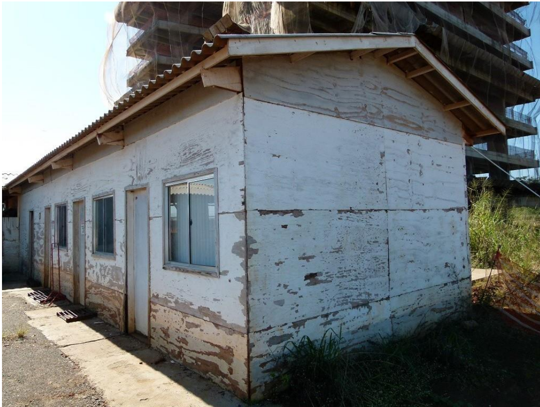
Instalações provisórias abandonadas pelo consórcio no canteiro em estado avançado de deterioração
