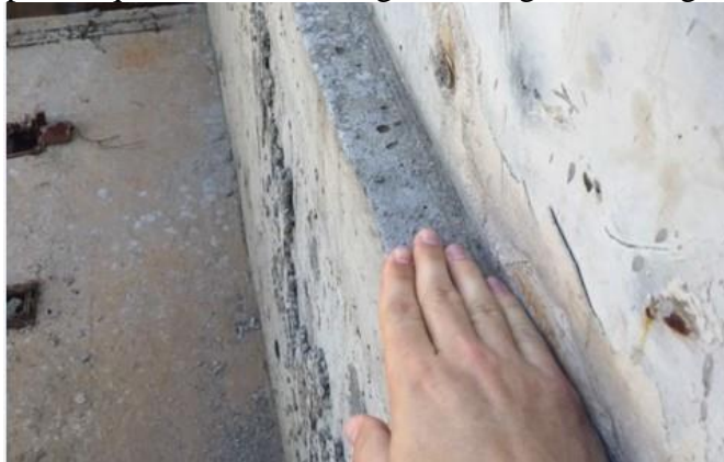
Figura 17 – Irregularidade do acabamento do concreto aparente de pilar do edifício de aulas na região de junção das formas Fonte: Acervo próprio da equipe do TCU
