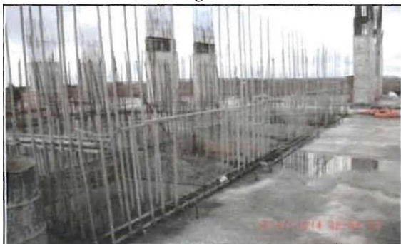
Figura 5 – Necessidade de proteção da armadura de arranque dos pilares
