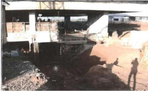
Figura 3 – Necessidade de proteção do subsolo do edifício central contra alagamento
