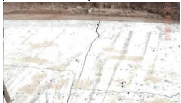
Figura 8 – Necessidade de reparos das proteções mecânicas e de execução de aterro sobre a proteção mecânica
