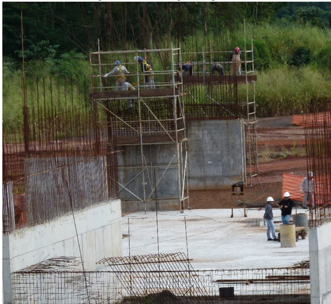
Foto 1 - Constatação da equipe em campo: pessoal da contratada recortando aço da espera dos pilares do prédio de aulas (que receberá outros andares) para utilização imediata em outras estruturas da obra, pela falta de recursos para comprar novos materiais
