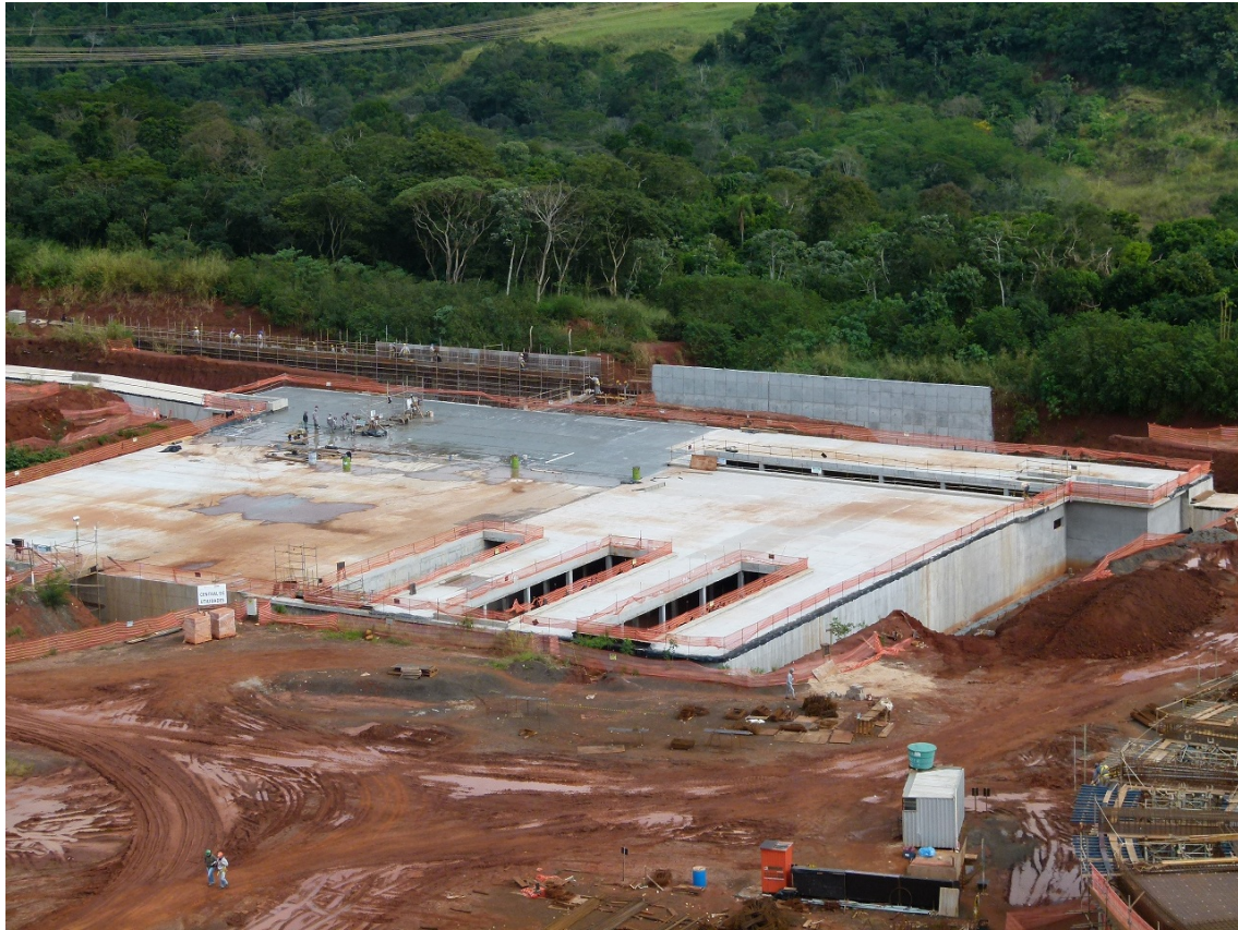
Central de Utilidades (CUT)
