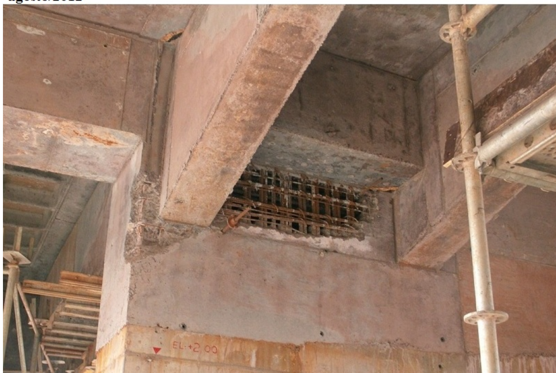
Foto 2 - Falha na concretagem da estrutura do 1º pavimento do Edifício Central agosto/2012
