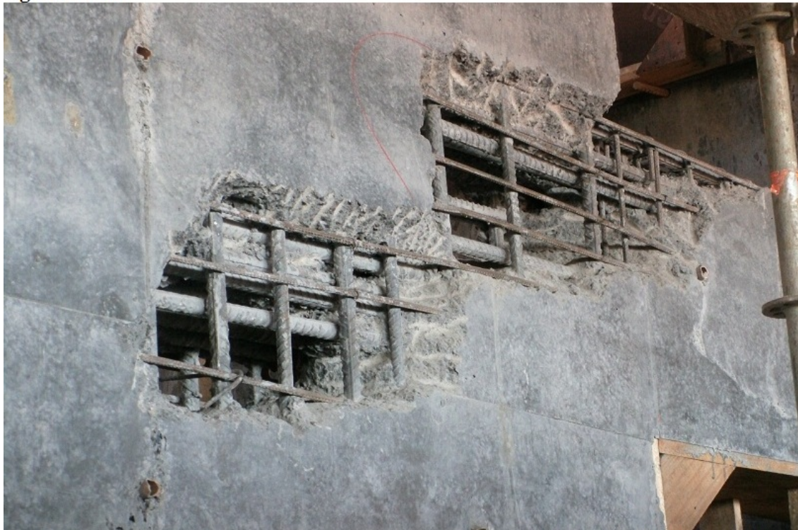
Foto 5 - Falhas na concretagem da estrutura do 7º pavimento do Edifício Central - agosto/2013
