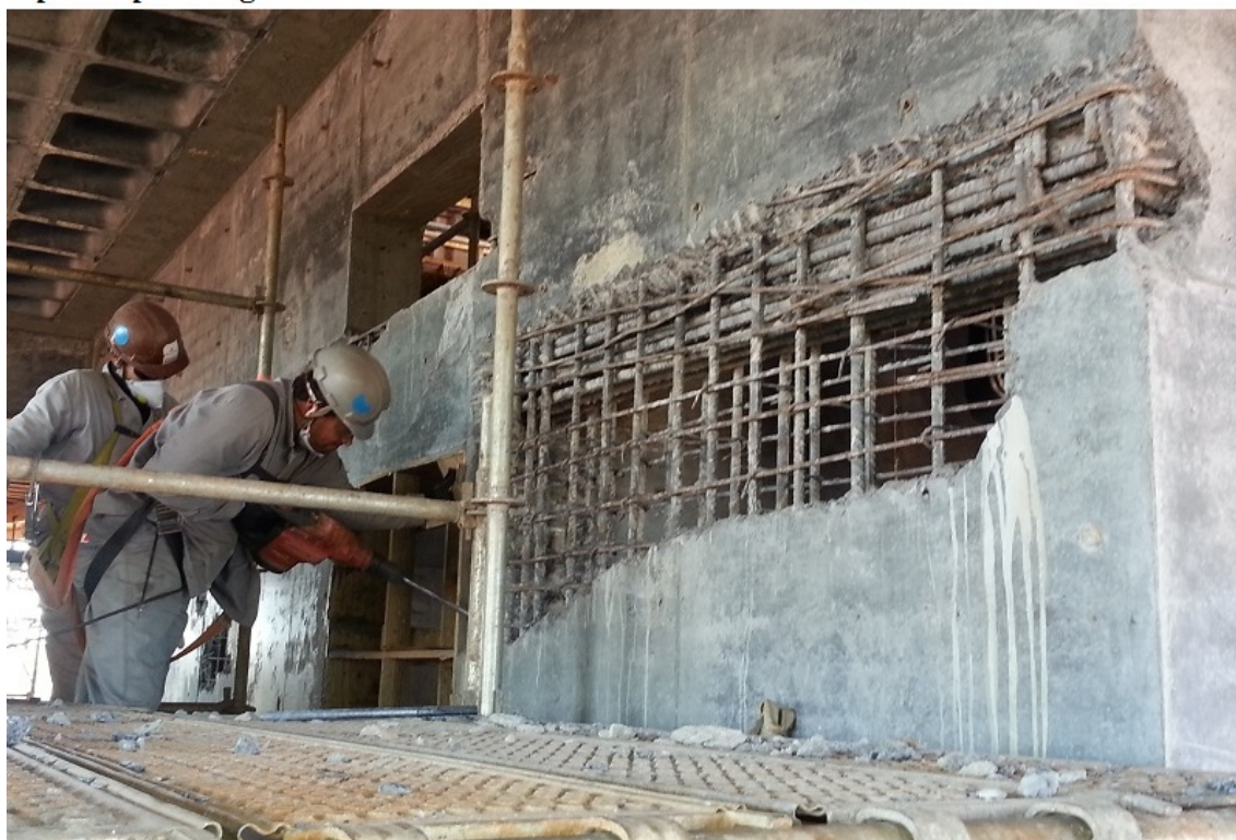
Foto 4 - Grande falha na concretagem da estrutura do 7º pavimento do Edifício Central após limpeza - agosto/2013
