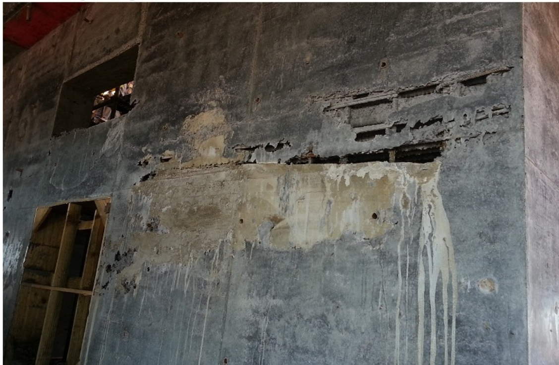
Foto 3 - Grande falha na concretagem da estrutura do 7º pavimento do Edifício Central antes da limpeza - agosto/2013
