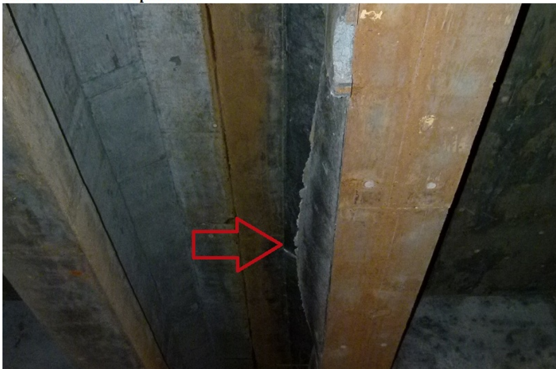
Foto 6 - Face lateral de viga 'embarrigada' na estrutura do 1º pavimento do Prédio de Aulas - vista de baixo para cima
