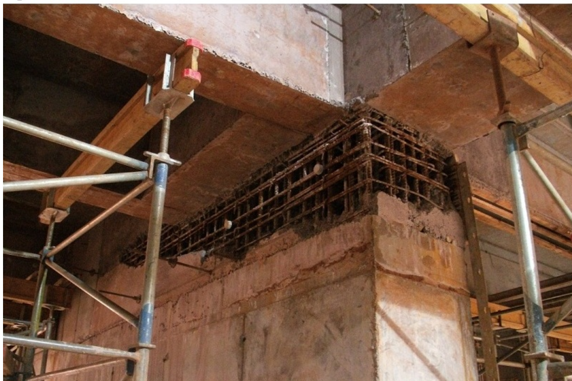
Foto 1 - Grande falha na concretagem da estrutura do 1º pavimento do Edifício Central agosto/2012
