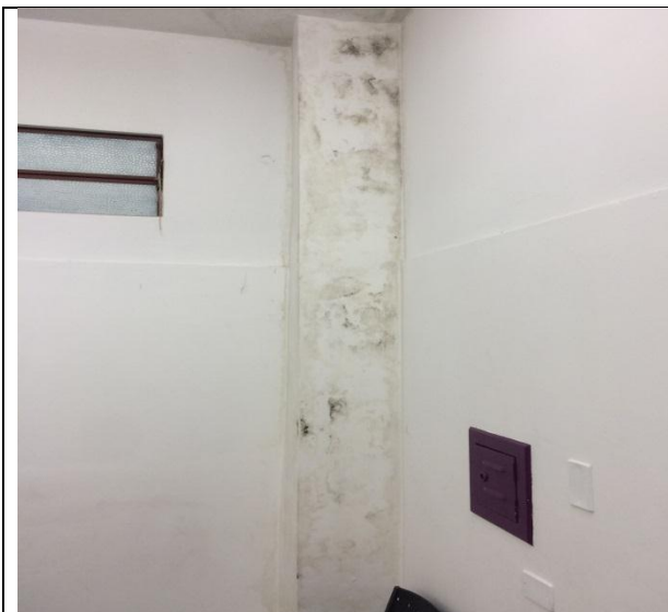
Sala 01 umidade aparente.
