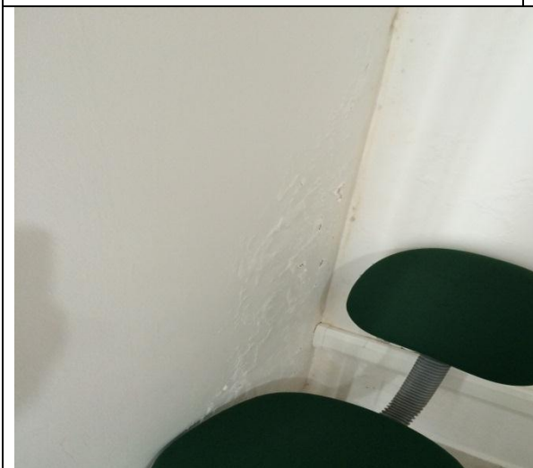
Sala 14 – pintura requer reparos.
