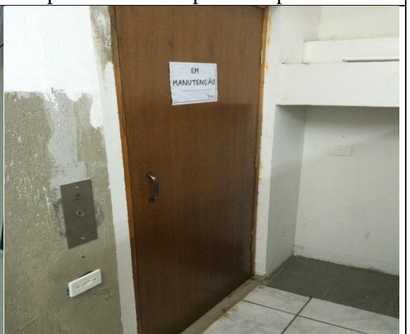
Elevador sem funcionar.
