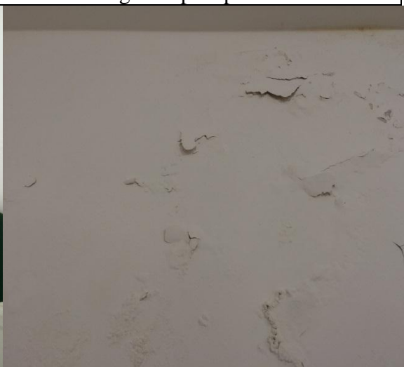
Sala 14 – pintura requer reparos.
